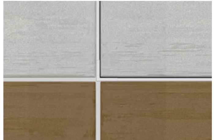
detail růžku bez spárování
